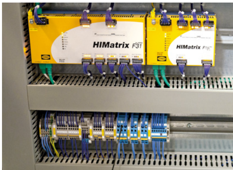
Die HIMatrix im Schaltschrank koordiniert die übrigen Steuerungen in den Fahrzeugen
